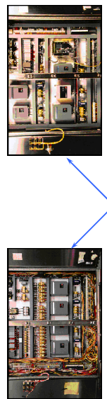
Κεντρικός πίνακας πριν και μετά το DeviceNet.
